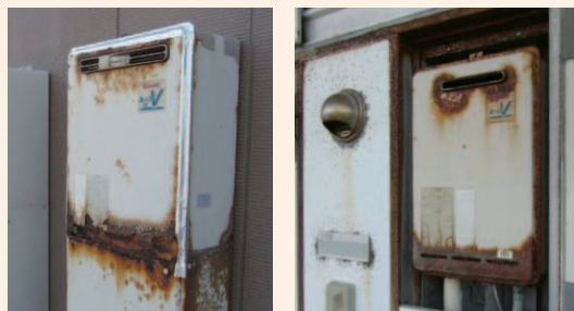
【塩害により腐食したガス給湯器】
