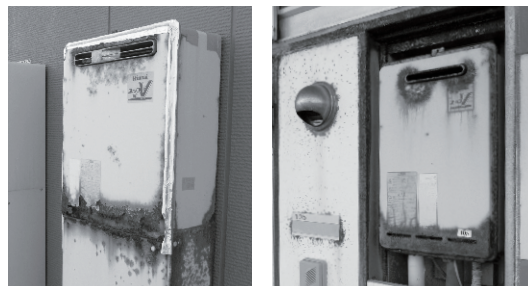
【塩害により腐食したガス給湯器】
